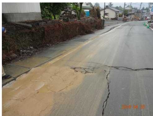
写真1 道路の一部亀裂、泥吹き出し
