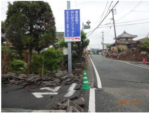
写真3 路肩の右ずれ
