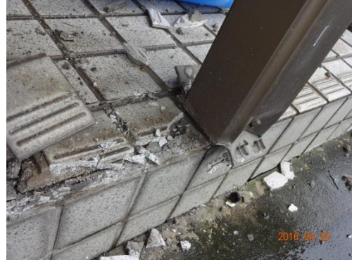
写真4 鋼材柱の脱落
