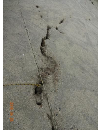
写真6 亀裂から噴砂?
