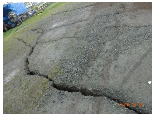
写真10 町民グラウンドの亀裂、噴砂
