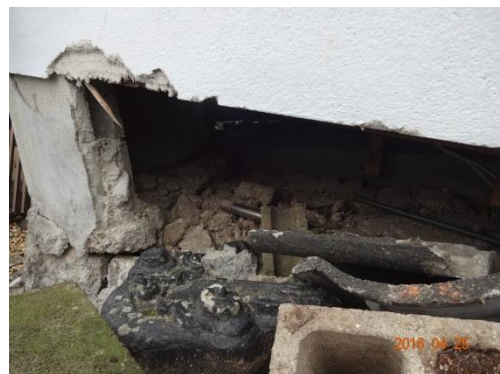
写真8 地盤の崩壊、基礎の損傷
