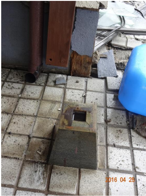
写真3 基礎の固定孔と抜けた柱
