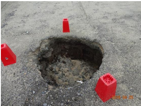
写真7 同じ場所、古井戸が陥没
