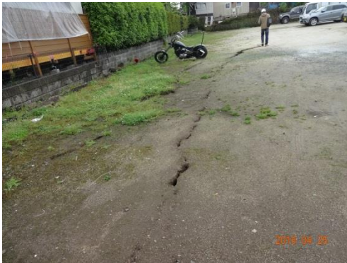
写真5 病院駐車場から東に続く亀裂
