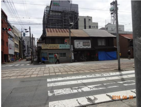
写真7 手前木造崩壊危険で通行止め
