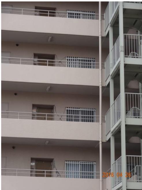
写真3 玄関横の壁に亀裂
