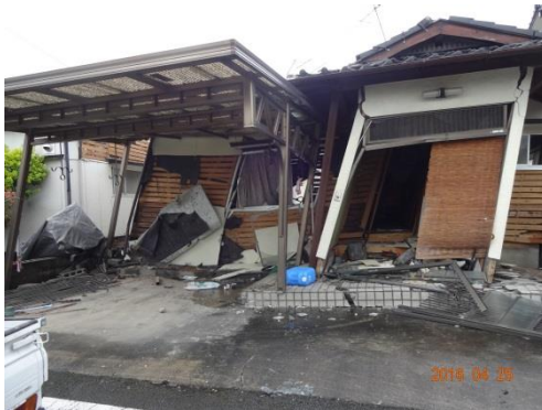
写真1 玄関、車庫の倒壊
