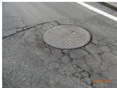
写真2 マンホール浮き上がり
