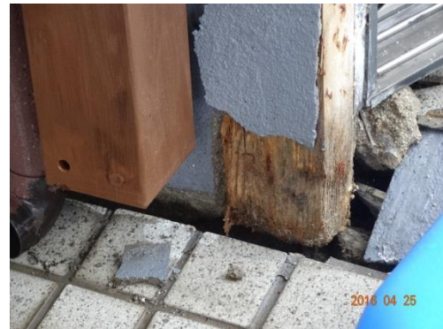
写真2 柱が基礎から抜けている
