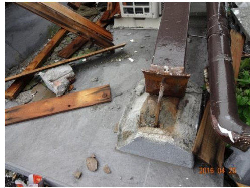
写真6 鋼材柱のボルトが抜けている
