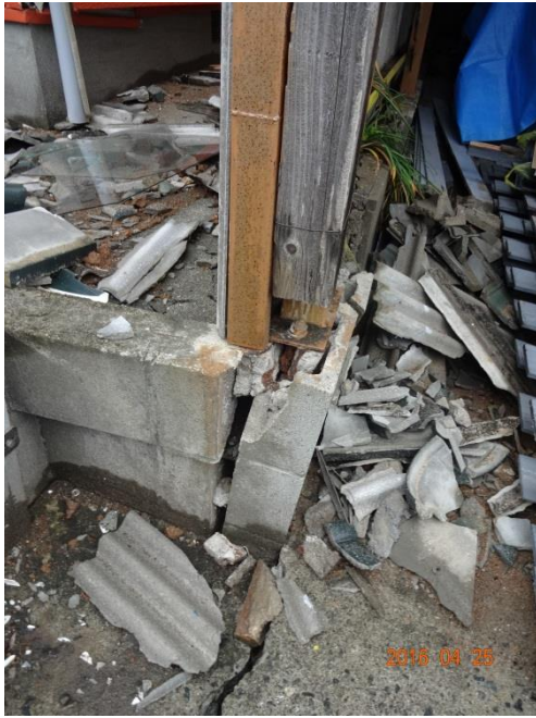
写真5 鋼材柱が基礎より離脱
